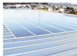
本社屋上の太陽光パネル
