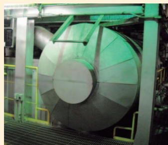
発電用ボイラー
