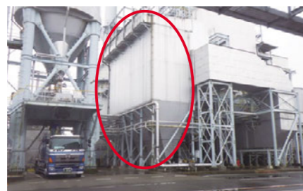
除害設備(バグフィルター) 捕集した灰をトラックでリサイクル先へ搬出
