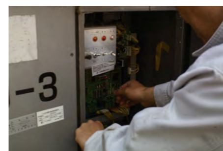
供給電流自動遮断装置の導入
