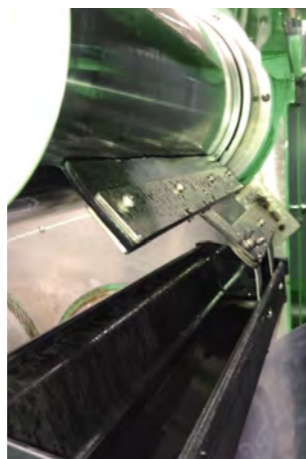
排水回収装置
