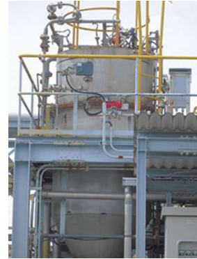
化学物質除去装置
