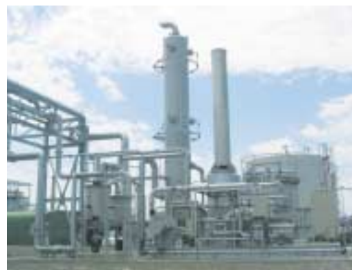
臭気センサー等から得られた情報を元に導入した新たな臭気発生抑制設備
