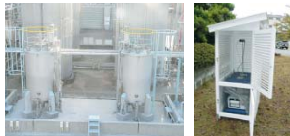
臭気吸引ラインの新設 臭気センサー
