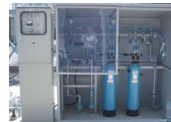
活性炭使用の排水処理設備
