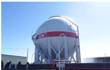
高圧ガスタンクへの散水
